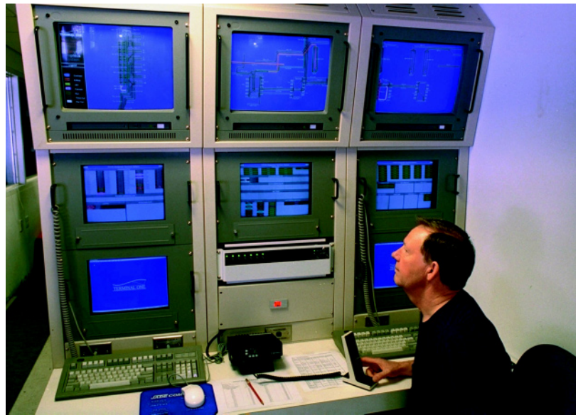
Peoples Gas Systems Inc. 的基于 PLC 的通讯接口
